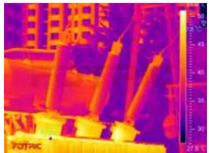
220kV设备区热像图
