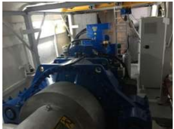
风机机舱发电机实物图
